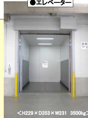
●エレベーター
